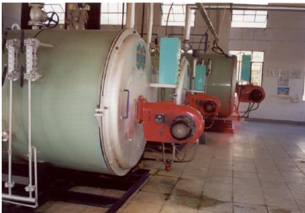
圖 2 A 廠三座蒸汽鍋爐外觀實景
