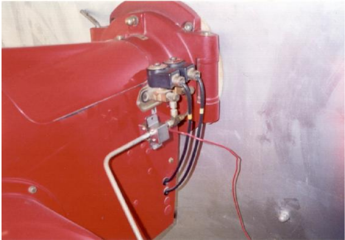
圖 9 A 廠鍋爐燃燒機重油進油管上安裝流體磁化器
