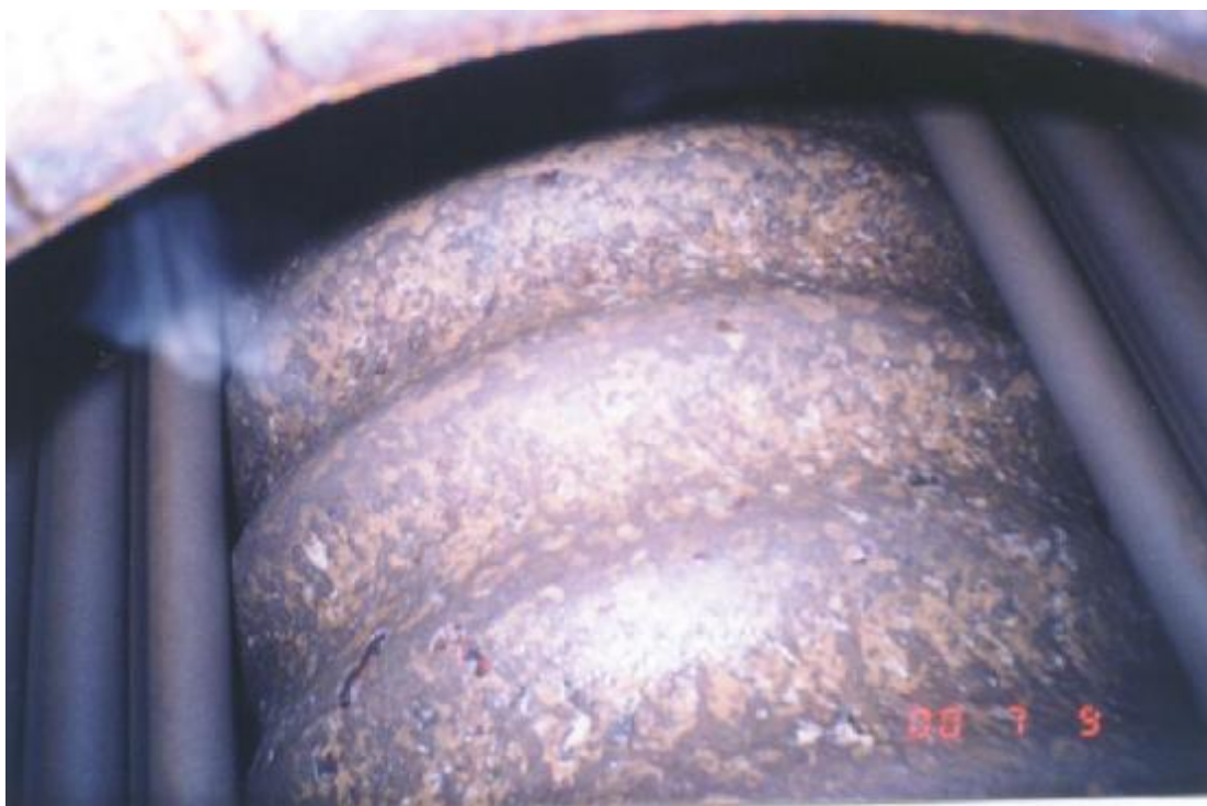
圖 11 鍋爐安裝流體磁化器後鍋垢脫落並不再形成
