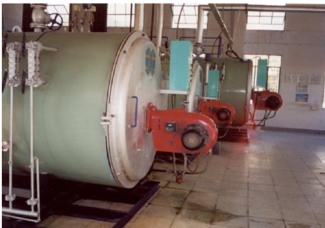
圖 2 A 廠三座蒸汽鍋爐外觀實景
