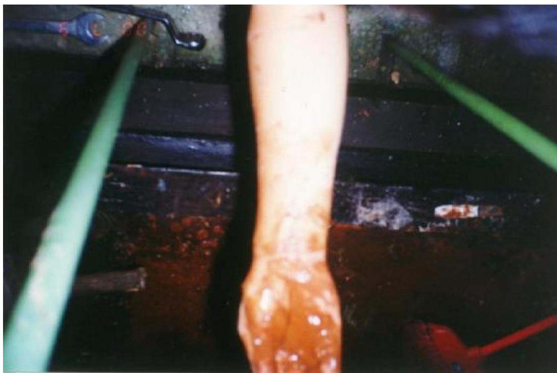
圖 12 鍋爐安裝流體磁化器後硬垢變成軟泥型態
